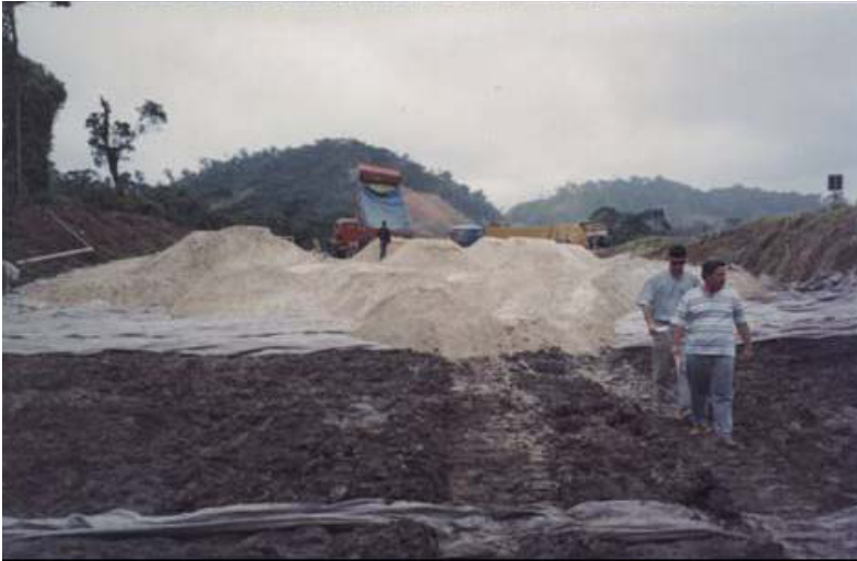
Espalhamento do aterro sobre o geotêxtil Bidim. Notar uma trincheira drenante em primeiro plano.
