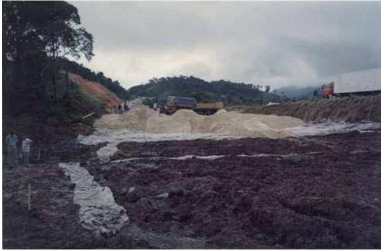
Vista da trincheira drenante lateral e do aterro em segundo plano. Notar as trilhas de rodas no solo mole.
